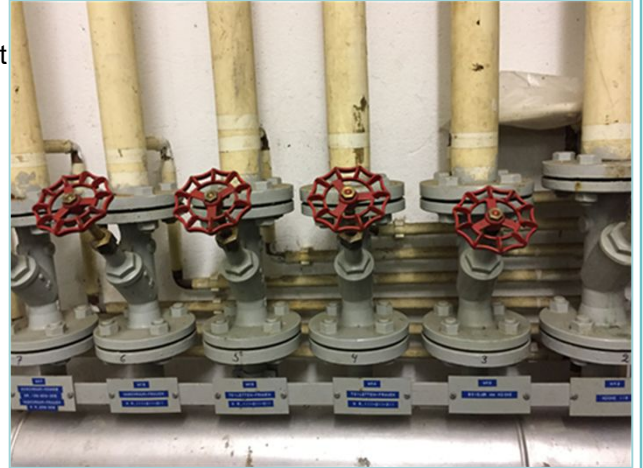
Hauptleitungen der Wasserversorgung
