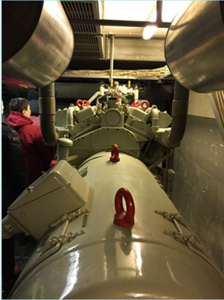
Einer der beiden 12-Zyl. Motoren mit Generator zur Versorgung des gesamten Bunkers mit u.a. Strom und Lüftung.
