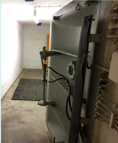
Die hydraulisch und mechanisch zu betreibende Bunkertür
