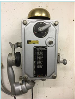
Interne Verbindung zu allen Stationen
