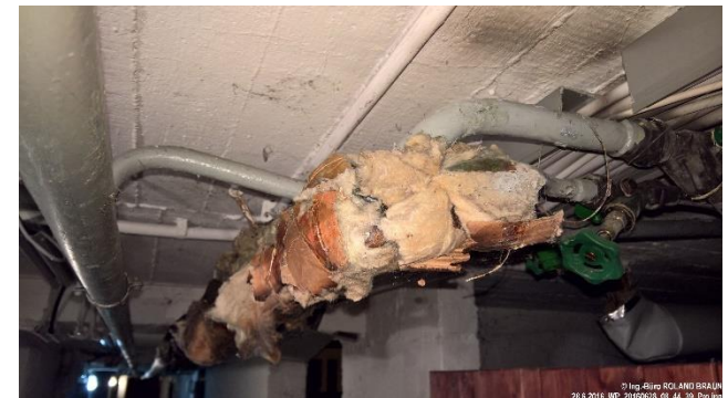
Rohrisolierung aus alter Mineralwolle
