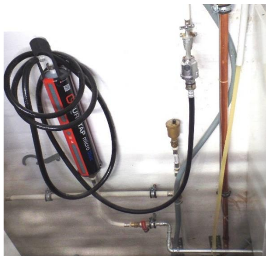
Heizung über Wasserenthärter und Schlauch fest mit Wasserhahn verbunden
