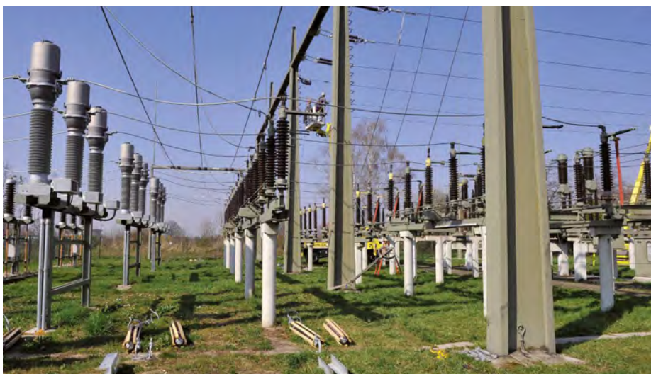
Umspannanlage Hüttenbühl – ein Baustein für eine sichere Infrastruktur zur Stromversorgung
