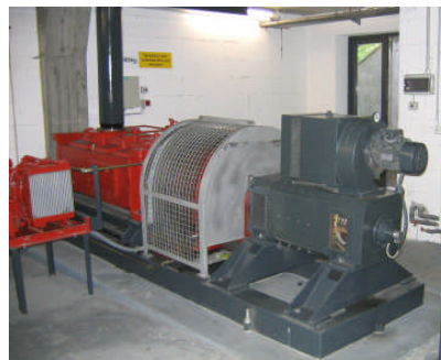
Antrieb: Motor mit Lüftungsmotor. Schwung- und Bremsscheibe, Getriebe, senkrechte Welle
