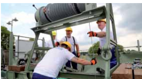
Mit Winde werden die Schützafeln gezogen.
