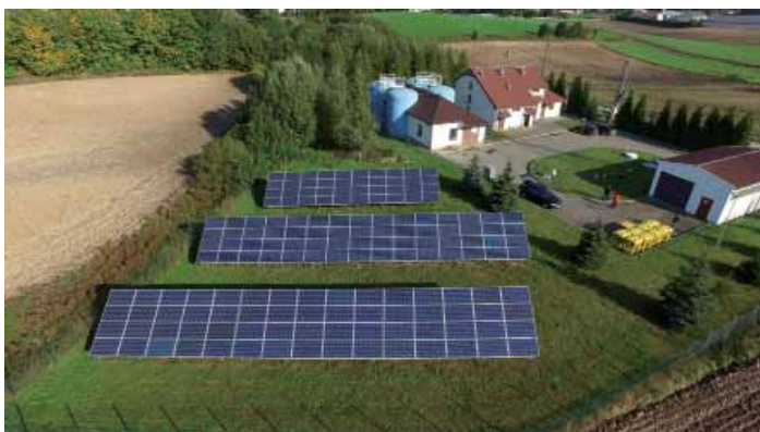
Photovoltaik-Anlage für nachhaltige, dezentrale Energieversorgung in Puńsk.
