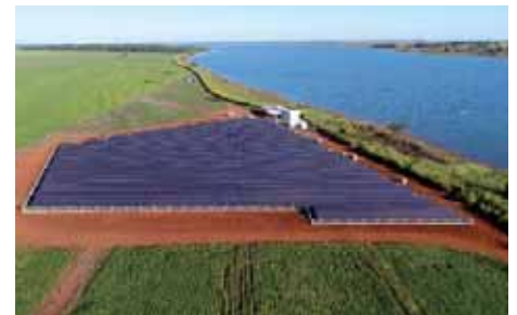
Auf der Mandengo-Farm in Quirinópolis, Brasilien, verringern Stromspeicher die Laufzeit des Dieselgenerators um bis zu 75 Prozent. Foto: Divulgação
