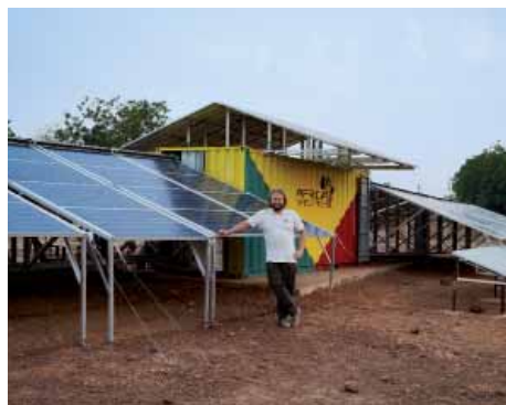
Stromspeicher von Tesvolt und Solarcontainer von Africa Green Tec versorgen 25 Dörfer in Mali zuverlässig und preisgünstig mit sauberem Strom.
