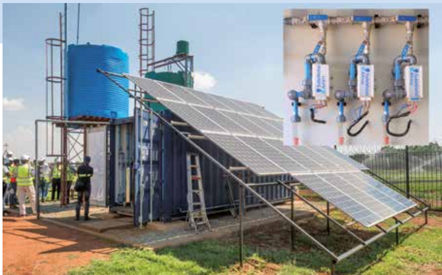
Diese Demonstrator-Trinkwasseraufbereitungsanlage in Südafrika desinfiziert Flusswasser mit Diamantelektroden und ist dank Solarzellen energieautark.
