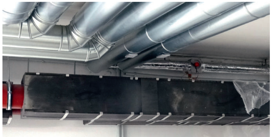
Abbildung 3: Außenansicht des gedämmten Rohrwärmetauschers AWT 2 als SML-Rohr mit ummanteltem Wärmetauscher
