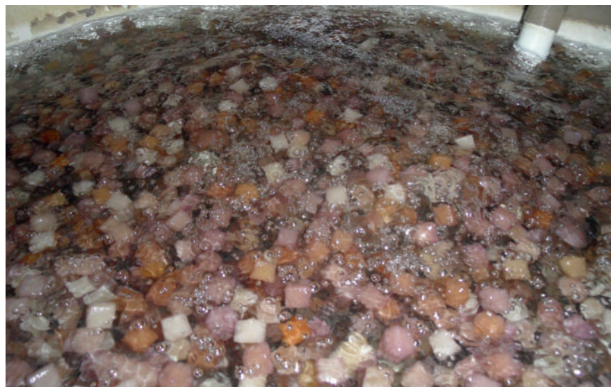
Abbildung 8: Blick in die biologische Grauwasseraufbereitungsstufe. Das Wirbelbett mit Schaumstoffwürfeln nach einer 15-jährigen Betriebszeit ohne Austausch der Reinigungskörper
