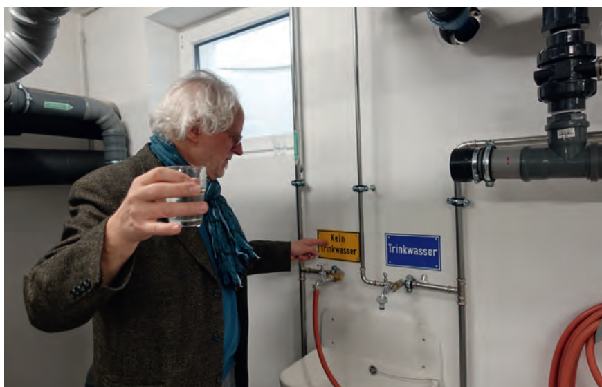
◀ Probenahme im Technikraum durch den Planer Erwin Nolde. Das Betriebswasser aus dem aufbereiteten Grauwasser ist weder durch Geruch noch Optik vom Trinkwasser zu unterscheiden. Es passiert zum Abschluss der Reinigung einen Sandfilter und die UV-Desinfektion. Verwendung hier: Toilettenspülung. | Bild: König
