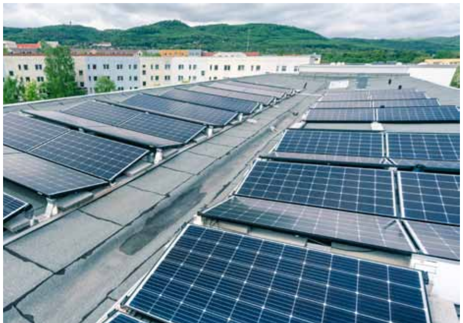
Diese Solarmodule sind Teil eines Mieterstromprojektes auf dem Dach eines Mehrfamilienhauses in der „Energiekommune“ Blankenburg. Foto: LENA/Manuel Pape
