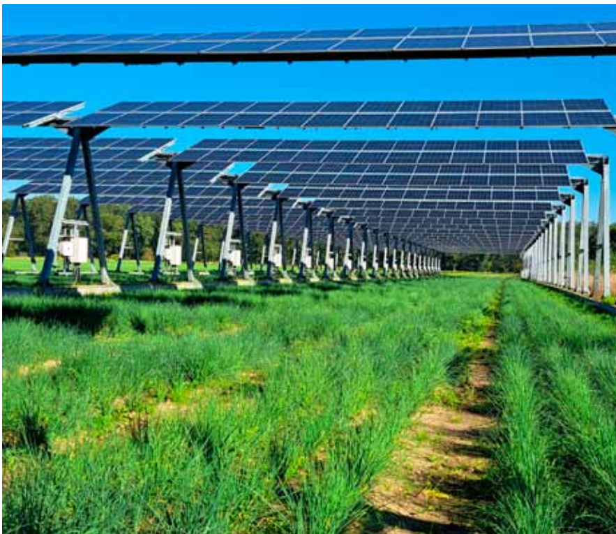
Diese PV-Anlage für Ackerland steht in Lüchow-Dannenberg. Foto: AgroSolar Europe
