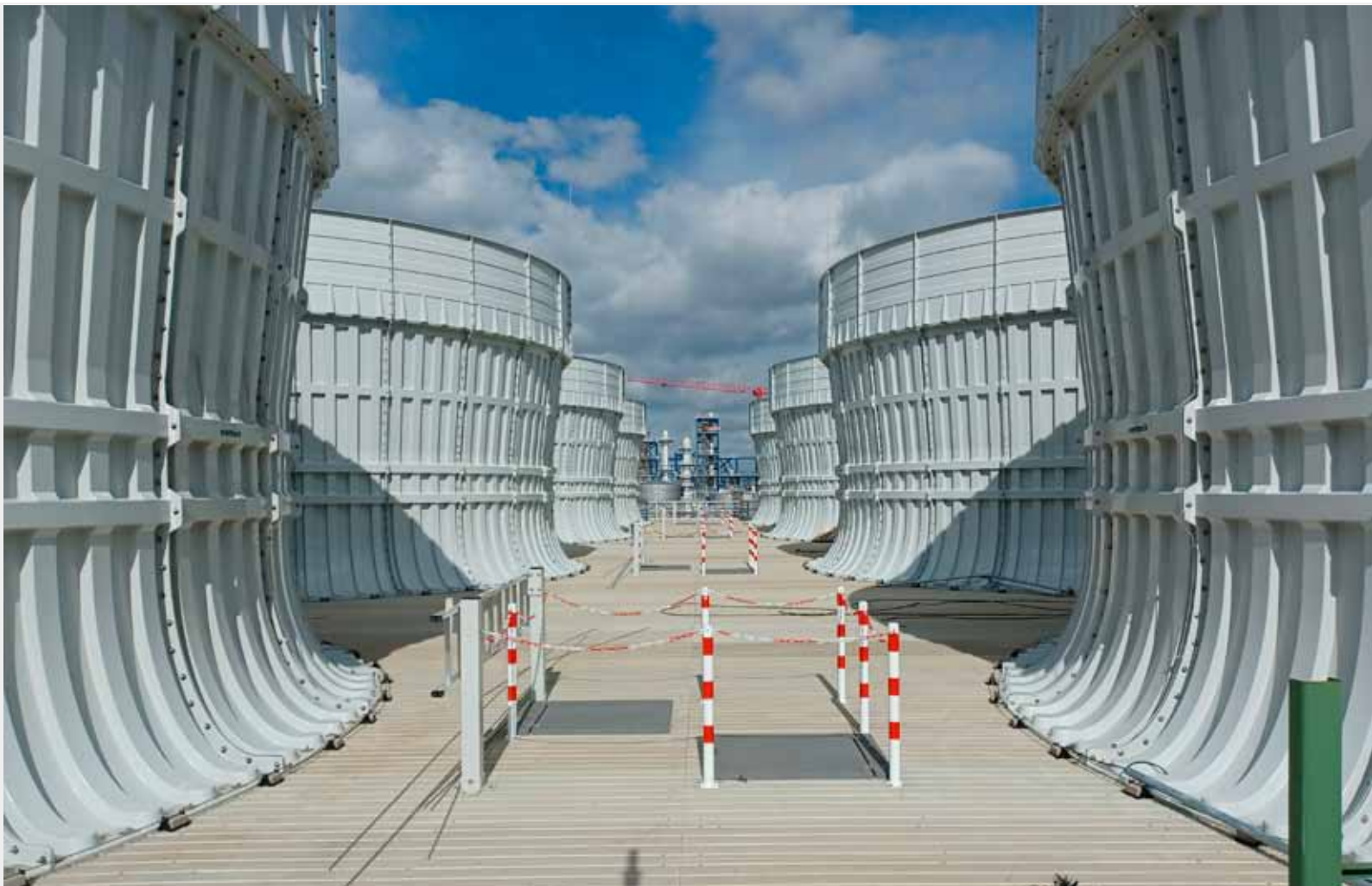
Die weißen Türme gehören zum neuen Rückkühlwerk der infraLeuna GmbH.
