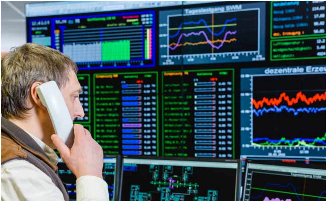
Ein Blick in die Netzleitstelle Strom der Netze Magdeburg GmbH, eine 100-Prozent-Tochter der SWM Magdeburg.
