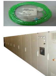
Schränke / Gestelle, Verkabelung
