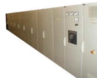
Schränke / Gestelle, Verkabelung
