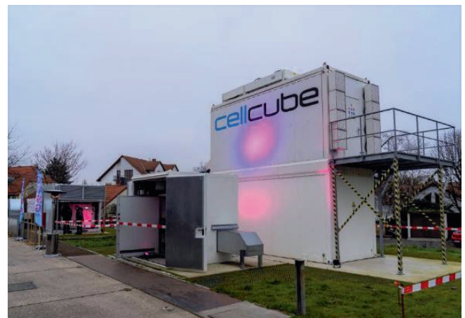
Batteriespeicher am Campus Rüsselsheim
