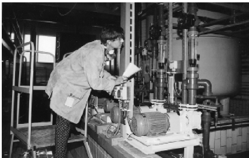
Bild 1: Dr. Stephanie Kehlberger prüft eine Anlage beim Kunden nach den Bestimmungen des Wasserhaushaltsgesetzes. Foto: Zimmermann
