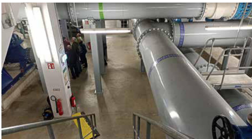
Verbundwasserwerk Essen: Einer der modernsten Trinkwasserlieferanten in Europa.
