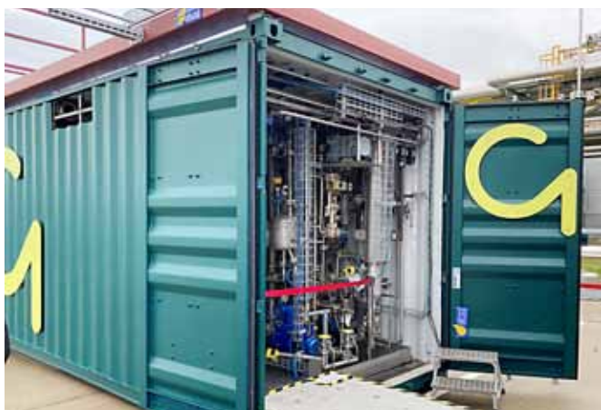
Die Pilotanlage zur Produktion von grünem Methanol steht im Chemiepark Leuna. Foto: InfraLeuna
