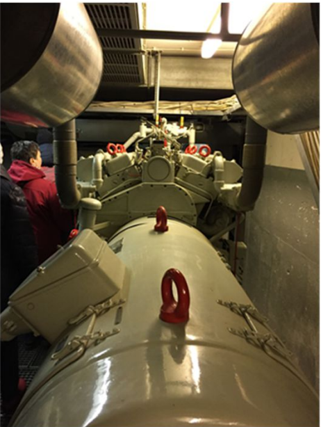
Einer der beiden 12-Zyl. Motoren mit Generator zur Versorgung des gesamten Bunkers mit u.a. Strom und Lüftung.
