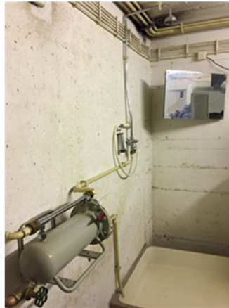
Dusche zur Dekontamination
