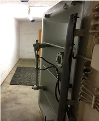
Die hydraulisch und mechanisch zu betreibende Bunkertür
