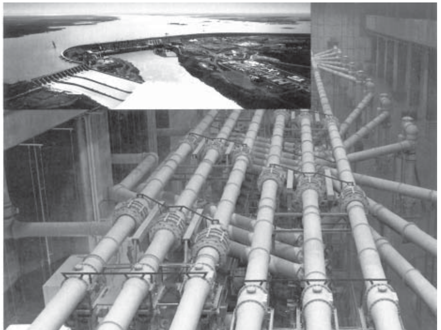
WKW Itaipu, 550-kV-SF 6 -Anlage
