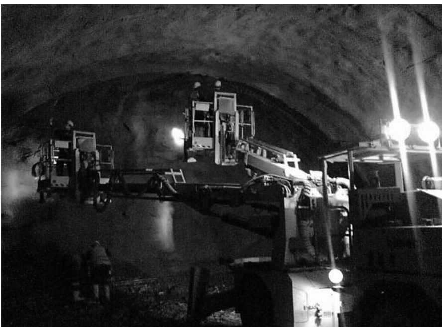
Die Sicherung des Gebirges erfolgt durch das Anbringen von Stahlgitterbögen, auf den Spritzbeton aufgebracht wird
